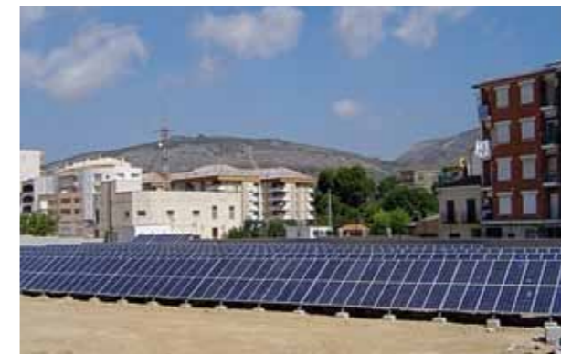
100 kWp – Muro de Alcoy (Alicante)
