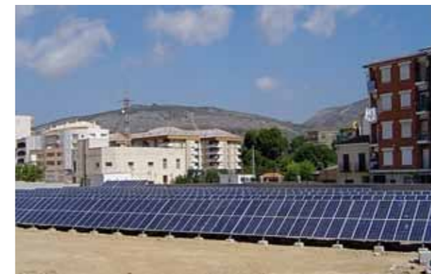
100 kWp – Muro de Alcoy (Alicante)
